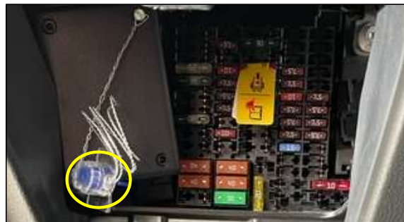
Figura 18. Precinto caja de conexiones.
