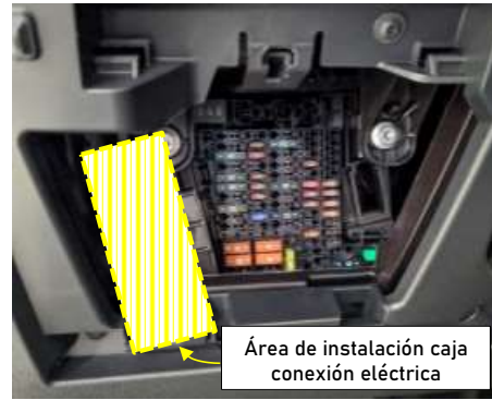
Figura 4. Área de instalación caja conexión eléctrica.
