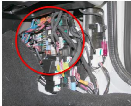
Fusible F202, de donde se toma la señal de 12V
