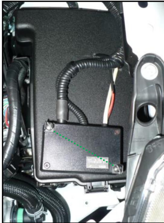
Caja de señales fijada en caja de fusibles
