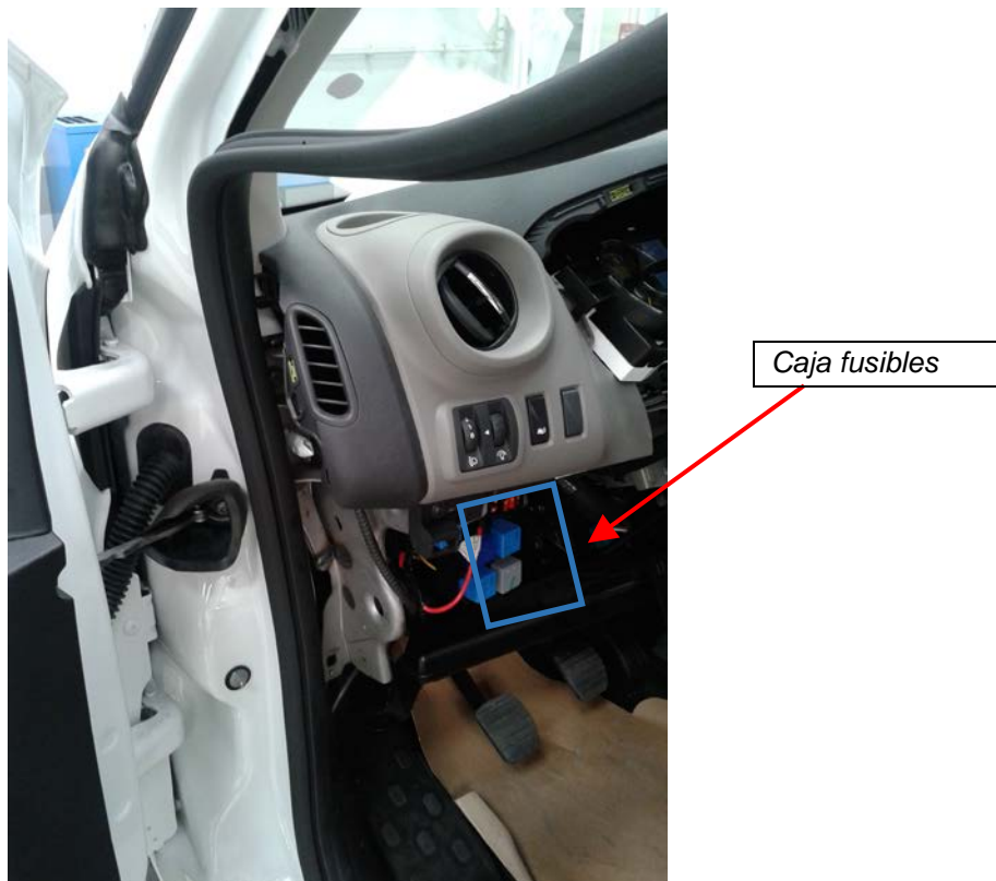
Fig. 3.1. Vista de la caja de relés, donde irá emplazada la caja conversor-adaptador.
