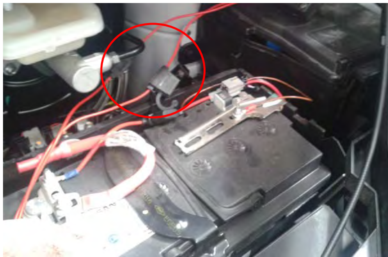
Fig. 2.1. Vista del fusible exterior
