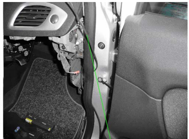
Cable del módulo
