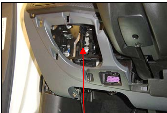
Ubicación de la caja de alimentación
