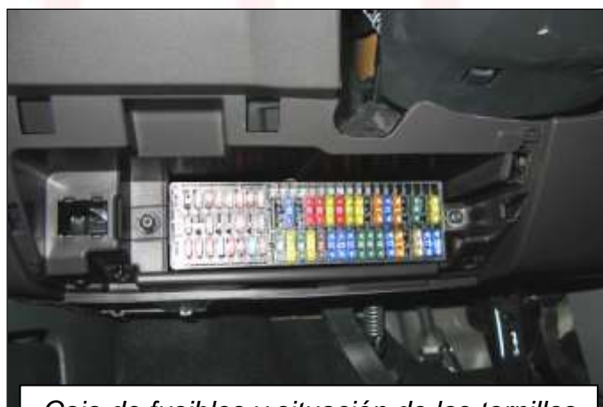
Caja de fusibles y situación de los tornillos
