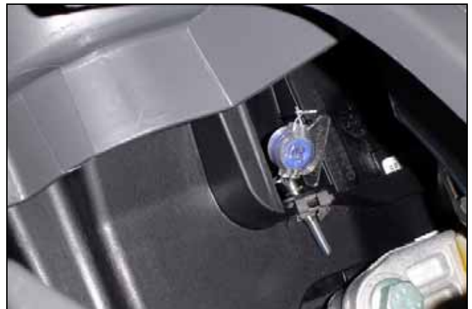
Vista desde la caja de fusibles
