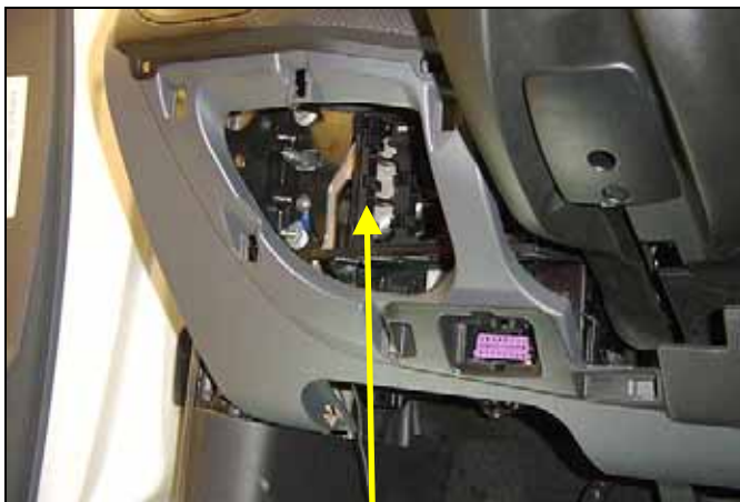
Ubicación de la caja de alimentación
