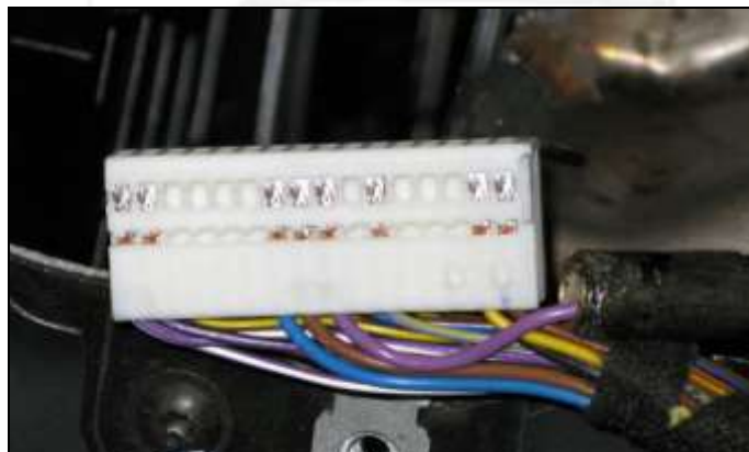
Conexión de la señal taquimétrica en el pin nº 9
