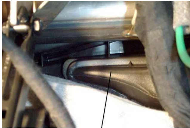
Canal de conducción de aire
