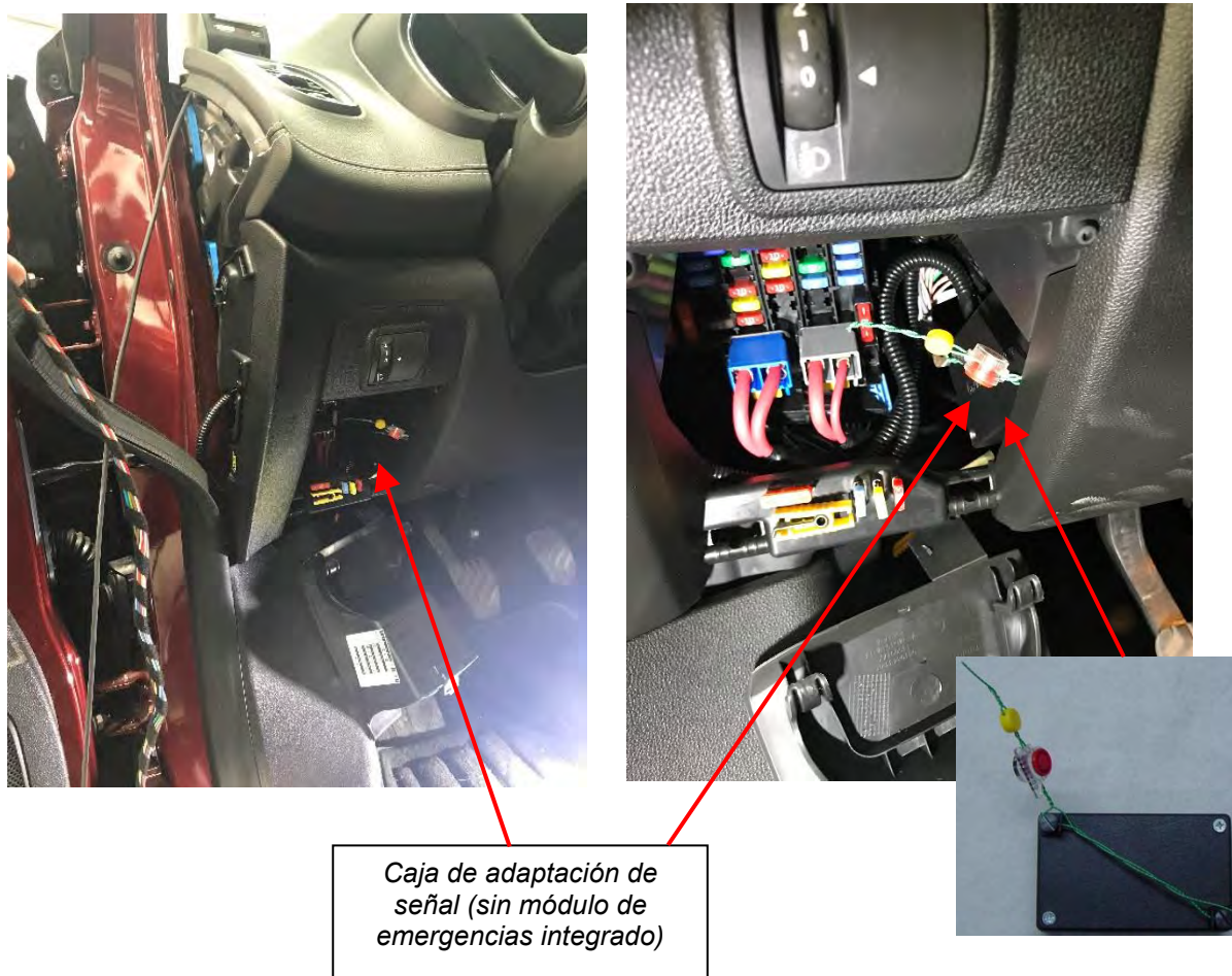
Fig. 3.1 y 3.2. Vistas del compartimento de fusibles con la caja adaptadora de señal y detalle del precinto.
