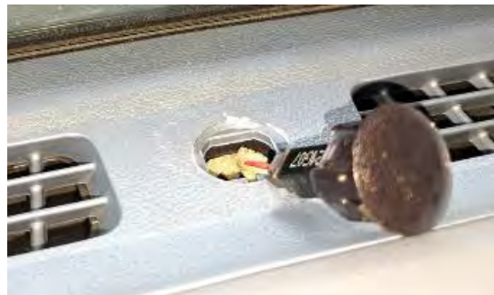
Fig. 4.1.3. Tapón extraído para paso de manguera blindada.
