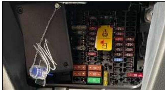
Figura 25. Precinto caja de conexiones.
