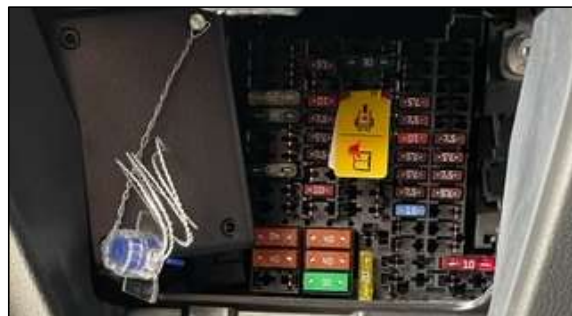
Figura 4. Caja de conexiones.
