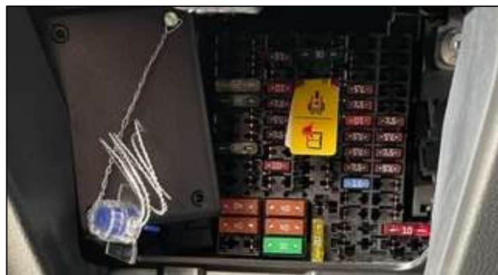
Figura 25. Precinto caja de conexiones.
