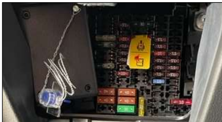
Figura 4. Caja de conexiones.
